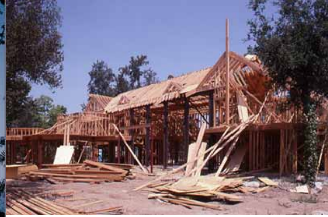
2x4の木造壁式構造体であったが開口部が大きすぎたこと、大きな吹き抜け空間があったことで、耐震用に沢山の鉄柱梁を入れなければならなかった。
